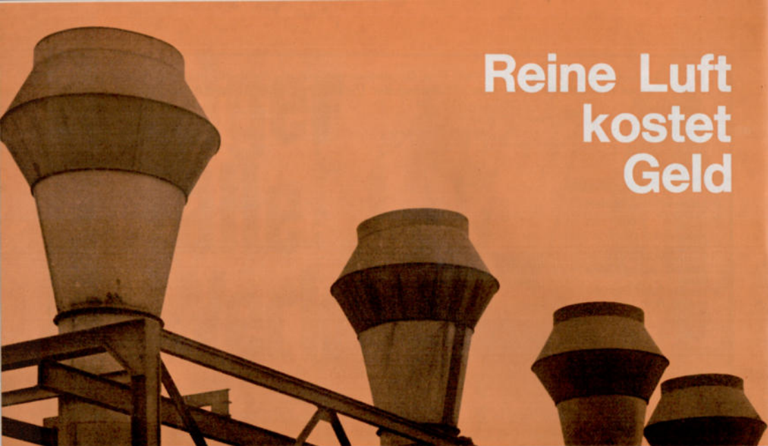
Das ist der auf dem Dach sich befindende Teil der Naßentstaubungsanlage.
