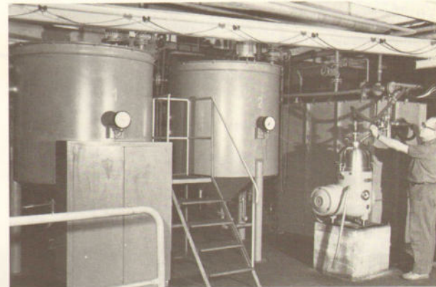
Die Armaturen der Anlage müssen ständig überwacht werden. Das ist die Aufgabe von Herrn M. Baltis, der dafür sorgt, daß Temperatur, Druck und Drehzahlen stimmen, damit immer die einwandfreie Reinigung des Wassers gewährleistet ist.
